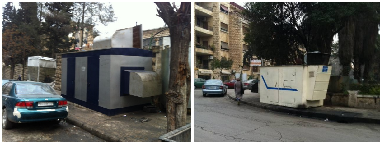
Figure 4. Installation des générateurs dans les espaces publics à Alep
