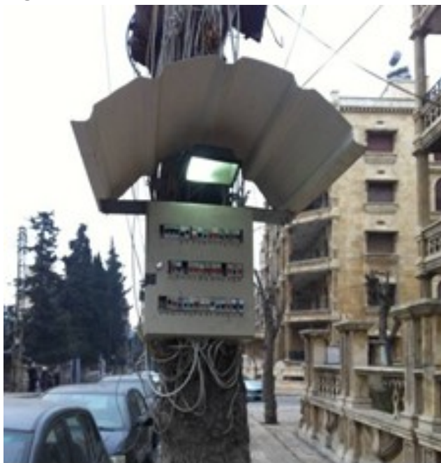
Figure 5. Tableau secondaire de distribution servant un îlot résidentiel du quartier Al-Sabil d'Alep
